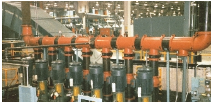
Tubería para calefacción, enfriamiento, lubricación, desechos y servicios públicos para procesos.
