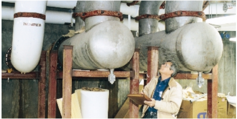
Tubería de acero inoxidable de hasta 24" (610.0 mm) disponible para servicios tales como estas líneas de suministro de agua desionizada.
