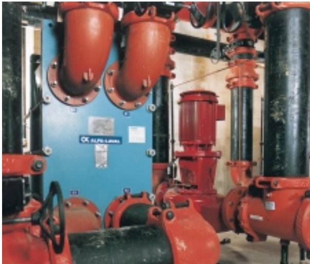
Aplicaciones desde calefacción, ventilación, aire acondicionado y protección contra incendios hasta aguas de pantoque, enfriamiento y potables se manejan con sistemas de Victaulic.
