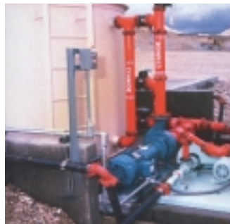
Tubería para procesos
