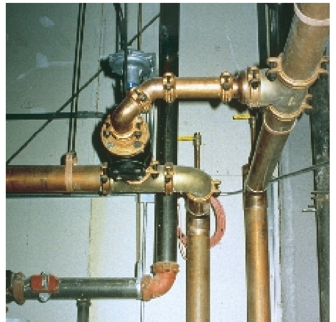
La conexión de cobre para servicios de plomería.
