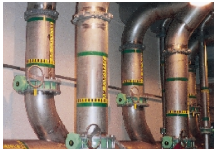
Alcantarillado, tratamiento de aguas y aire comprimido se encuentran entre los servicios típicos con sistemas de acero inoxidable Victaulic.
