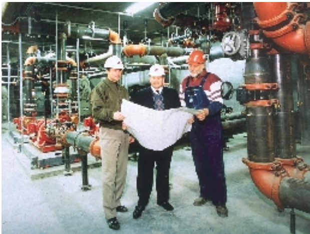
El diseño de sistemas totales desde bombas y equipos hasta sistemas de suministro, retorno y afines.
