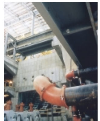
Desde el enfriamiento de mini rodillos a líneas de carbón BOF, el sistema Victaulic acelera la instalación de la tubería.
