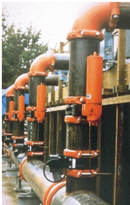
Válvulas automáticas para control del flujo de calefacción y enfriamiento
