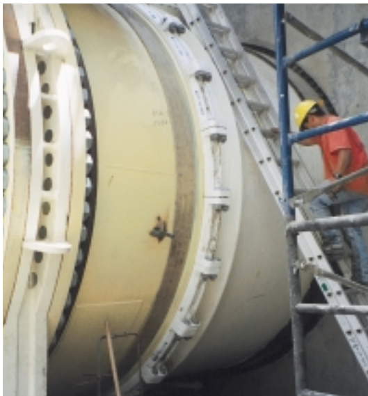
Se han utilizado acoplamientos de hasta 144 pulgadas para orificios de llegada y descarga, y tuberías de plantas de tratamiento de agua.
